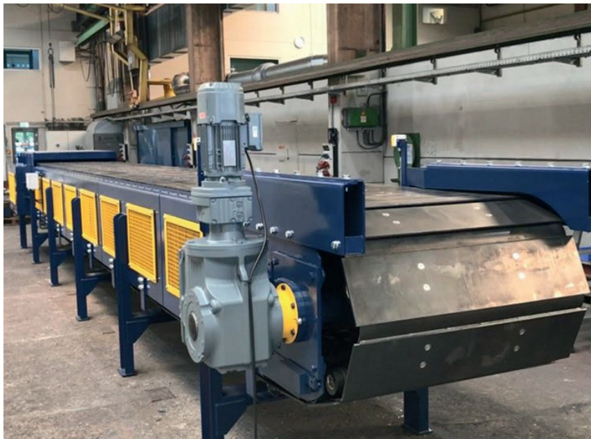
Conveyor in the Rheinberg production site. Förderer in der Produktion in Rheinberg. (Photo: AUMUND)
